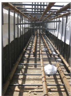
وجود مواد زاید در محل بتن ریزی
