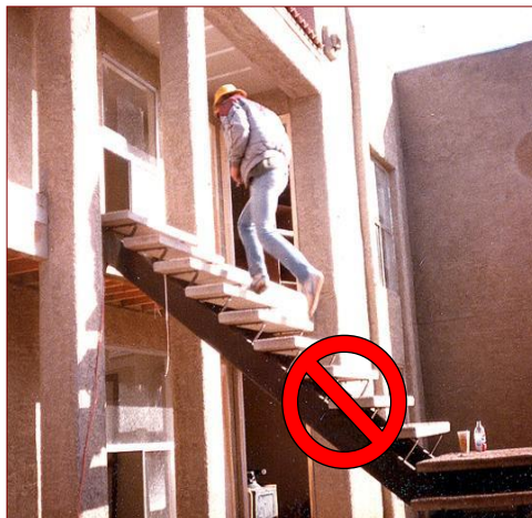
عدم استفاده از نرده حفاظتی موقت
