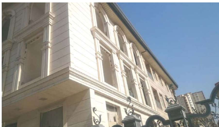
شکل ۹- عدم رعایت ارتفاع پنجره از کف و بزرگی بیش از حد. مغایر با مقررات ملی
