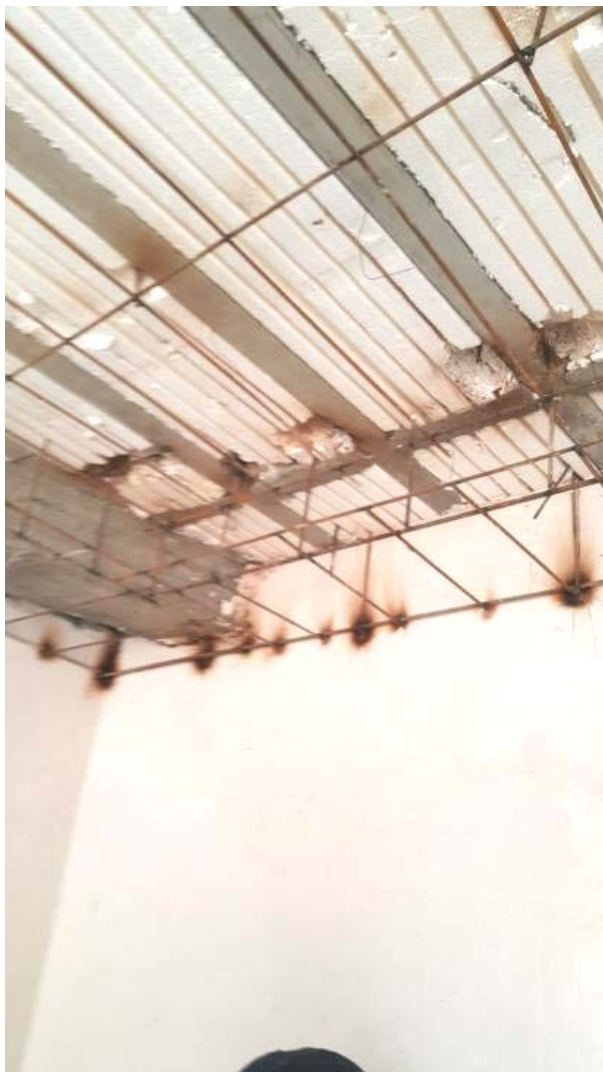
شکل ۱۸- سايورت گيري نامناسب از تيرچه و تخریب آنها
