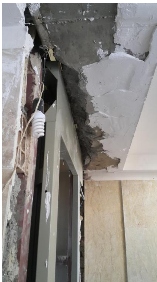
شکل ۱- تخریب پوتر برای نصب درب آسانسور به علت عدم دقت در جانمایی و کنترل ابعاد چاله آسانسور
